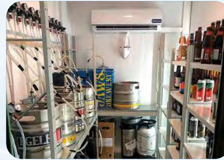
КАМЕРА ДЛЯ ПИВА ПОД КЛЮЧ г. Санкт-Петербург
